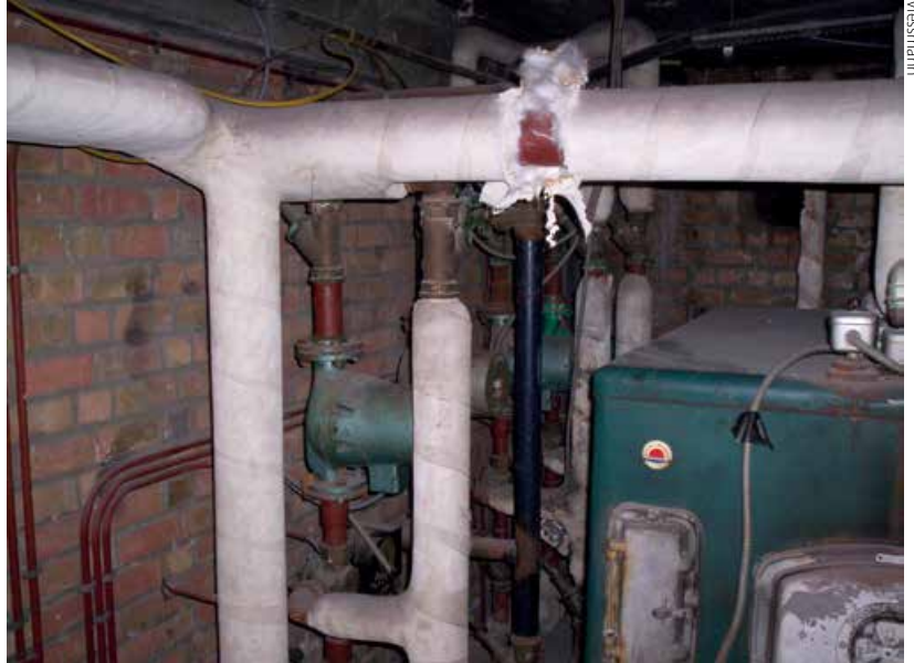
Isolatie in asbest
