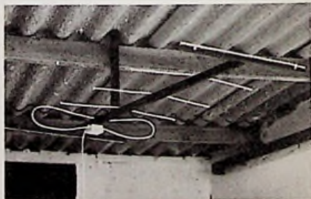
Afb. 39 6-Elements-VHF-antenne (kanaal 7), op zolder gemonteerd. (Deze kan ook voor de korte-, midden- en langegolfontvangst gebruikt worden.)
